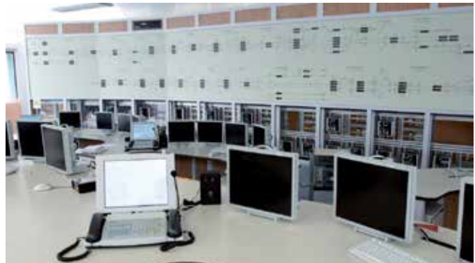
Le poste de commande à distance
